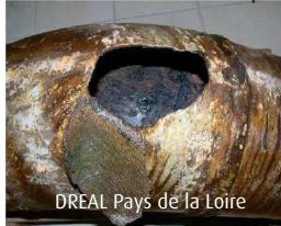
Corrosion en milieu humide par l'H 2 S
